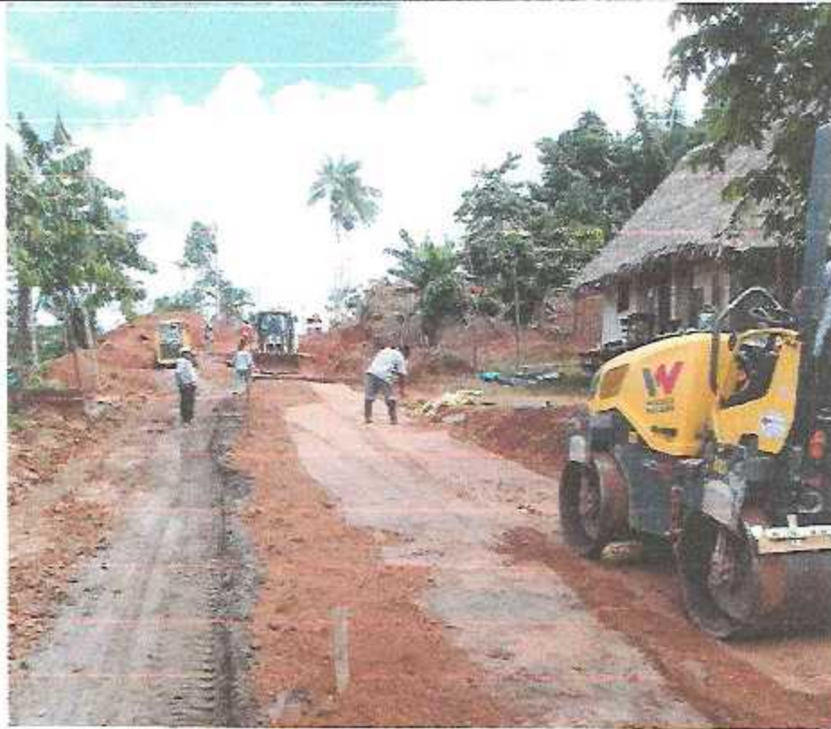
Imagen 1: Relleno compactado de terraplenes con material propio en tramo de vía mediante rodillo liso vibratorio autopropulsado.
