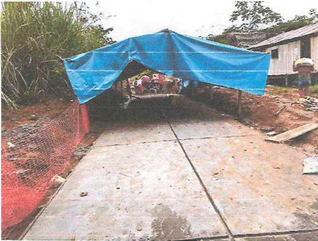
Imagen 9: Trabajos de vaciado de mortero f'c=210 \text{ kg/cm}^2 en losa de rodadura de la vía.
